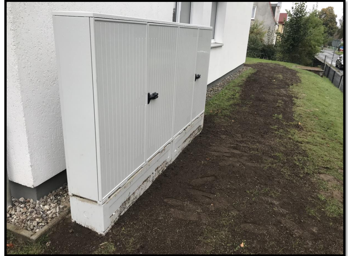
Gesonderter Netzanschluss und Elektroverteilung im Außenbereich mit Wandlertank (>40kW)
