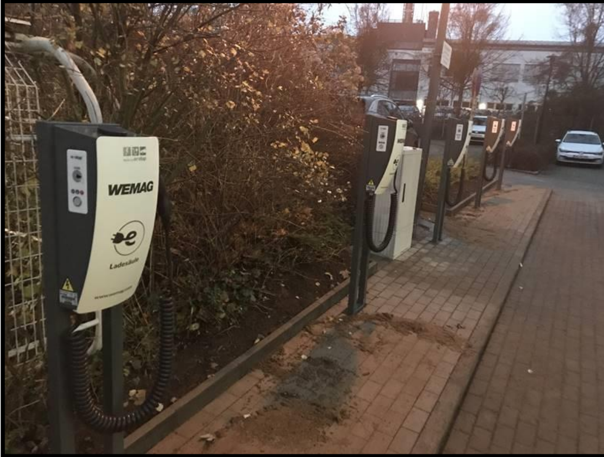
Gesonderter Netzanschluss und Elektroverteilung im Außenbereich mit Direktmessung (<40kW)
