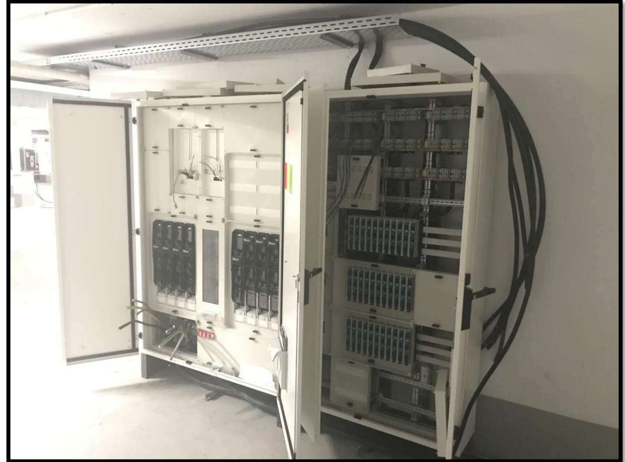
Gesonderter Netzanschluss und Elektroverteilung in der Tiefgarage (falls notwendig)
