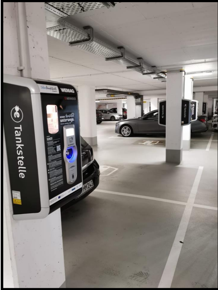
Exemplarische Wallboxen- und Kabeltrassenaufbau
